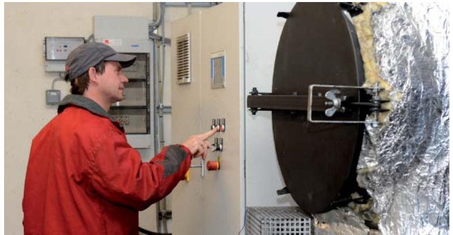
Wolfgang Hörandner am Schaltschrank seiner Holzverstromungsanlage
